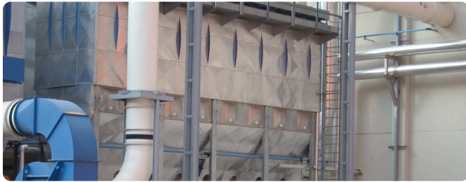
백필터 집진기 — 측면 방산패널 다열 장착
